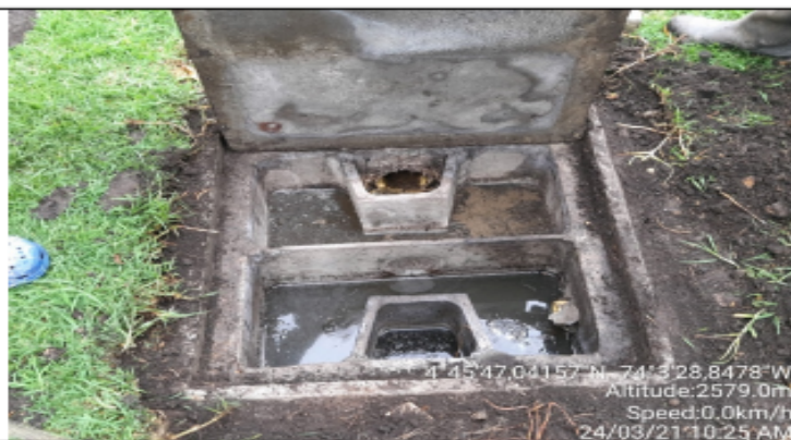
Fotografía 3 Trampa de grasas.
